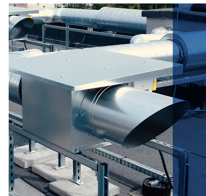
Wentylatory kanałowe zewewnętrzne
